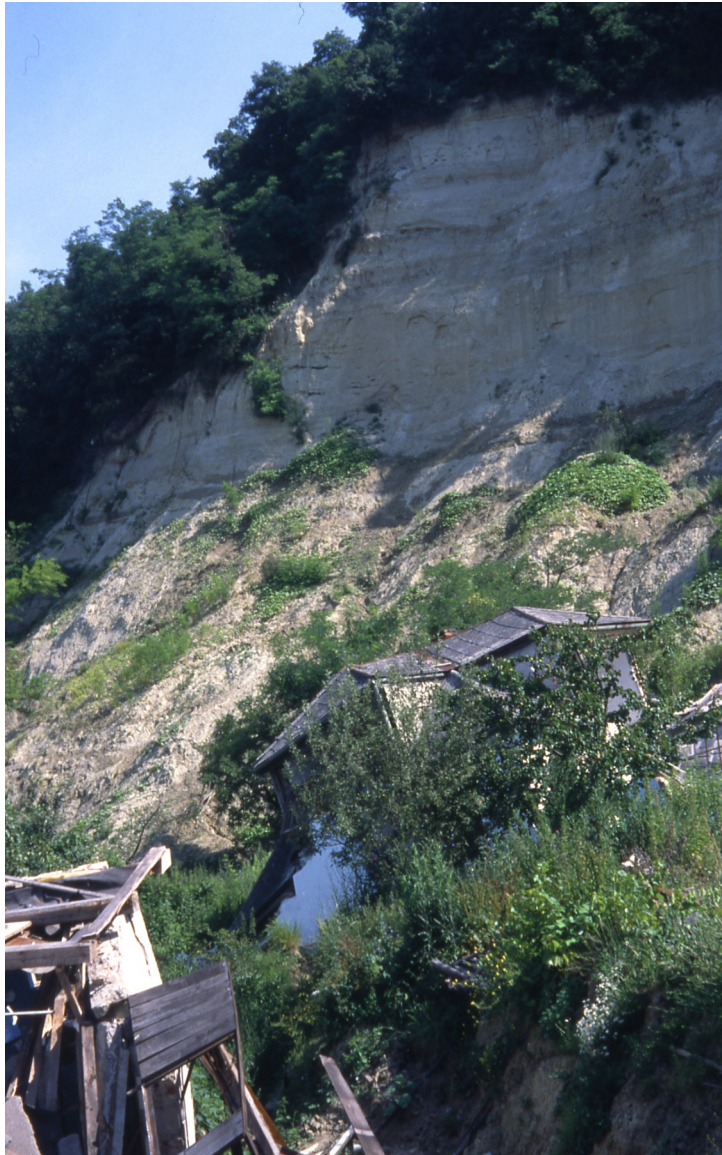
Rys. 1. Wzgórze Krásna w Koszycach (Słowacja). Osuwisko na zboczu nachylonym w kierunku rzeki Hornad. Fot. autora, rok 1999
