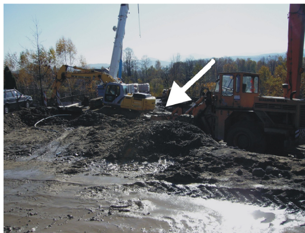
Rys. 11. Miejsce nad skarpą osuwiska, strzałka wskazuje miejsce otworu B3
