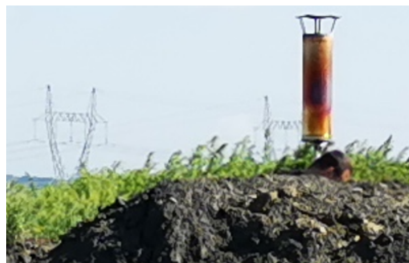
Fot. 3. Flara do awaryjnego spalania gazu ujętego na składowisku
